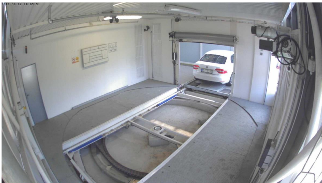
Obr. 3. Pohled z kamerového systému na paletu s automobilem vyjíždějící z kruhové otoče.
